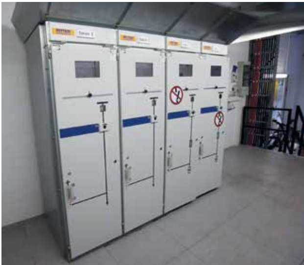
Das Zentrum ist mit seiner Übergabestation an den 10-kV-Ring des Energieversorgers redundant eingebunden.
