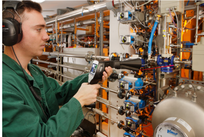
Leckagen in Druckluftnetzen gezielt lokalisieren und erhebliche Kosten einsparen.
