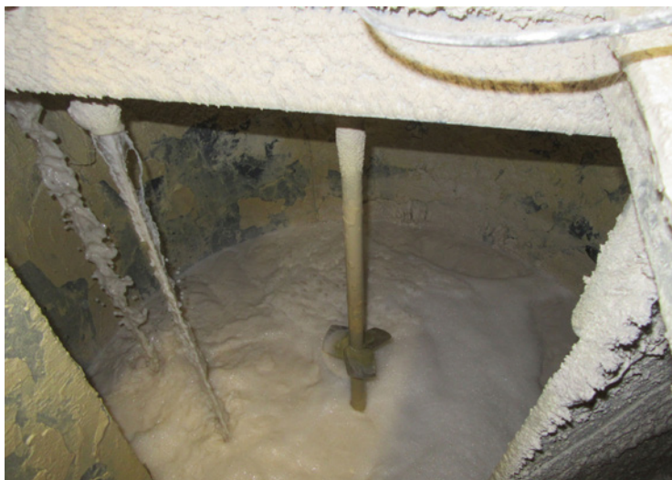
Blick in den Kalkmilchbehälter. Links vom Mischer ist die Stabsonde zu sehen, an der sich auch nach längerem Betrieb nur wenig Kalk abgelagert.
