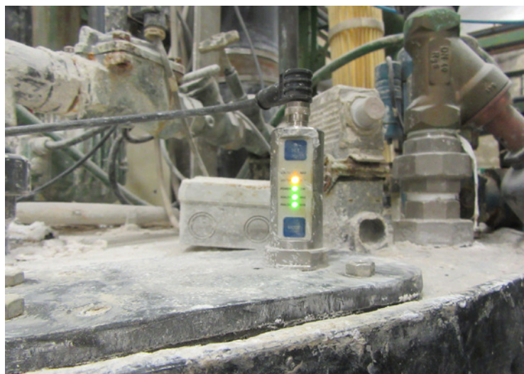
Gehäuse und Anschluss des kapazitiven Füllstandsensors bestehen aus Edelstahl. Deutlich erkennbar sind die Kalkablagerungen auch auf dem Behälter der Aufbereitung.
