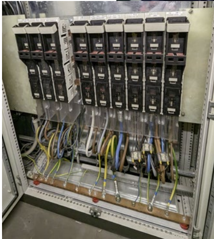
TN-C-Systeme mit klassischer Nullung und 4-Leiter-Technik sind aus Sicht der Anlagen-EMV anfällig für Störungen.
