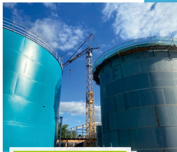
In zwei neuen Faultürmen wird der Klärschlamm bei Temperaturen von 35 bis 37 °C mithilfe von Mikroorganismen und Bakterien anaerob stabilisiert. Bilder: Porr
