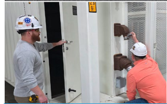
Korey Greene und John Salyers untersuchen die elektrischen Anschlüsse eines Containers, der für die Stromversorgung bei Arbeiten an transkontinentalen Unterwasserkabeln installiert wurde.
