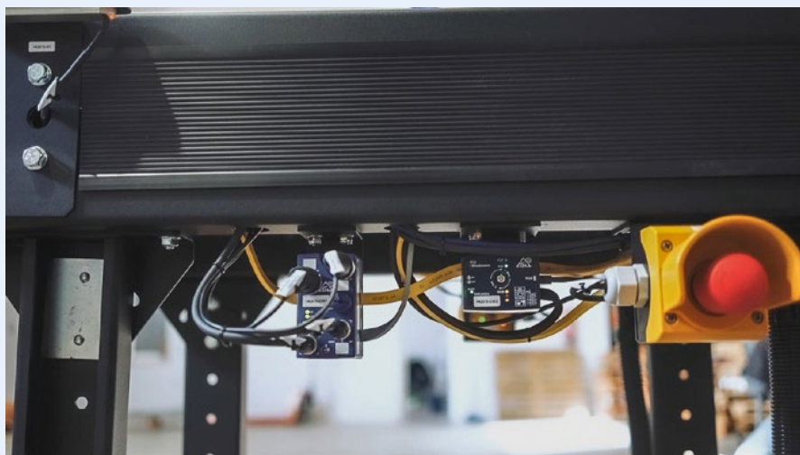
ASI-5 Motormodule für zwei 24 V Motorrollen vom Typ BWU4246 steuern die Motorrollen, die dieses Förderband antreiben, und regeln so die Geschwindigkeit und die Beschleunigung in den jeweiligen Abschnitten.
