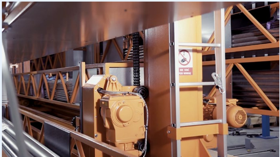
Für den Betrieb des Regalbediengerätes auf Schienen zwischen den Hochregalen kommen robuste Nord-Getriebemotoren zum Einsatz.
