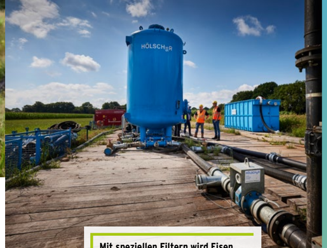
Mit speziellen Filtern wird Eisen aus dem Wasser entfernt und so das Wasser aufbereitet.
