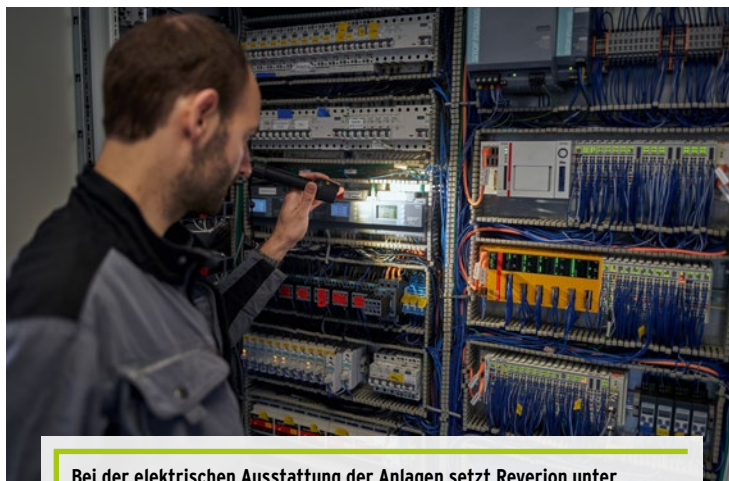
Bei der elektrischen Ausstattung der Anlagen setzt Reverion unter anderem auf Helukabel.
