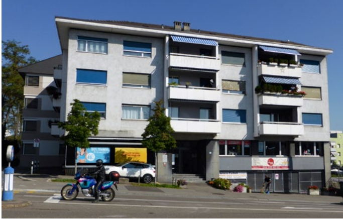
Vor der Sanierung: Die Fassade wirkt abgenutzt und das Gebäude befindet sich in einem veralteten Zustand.
