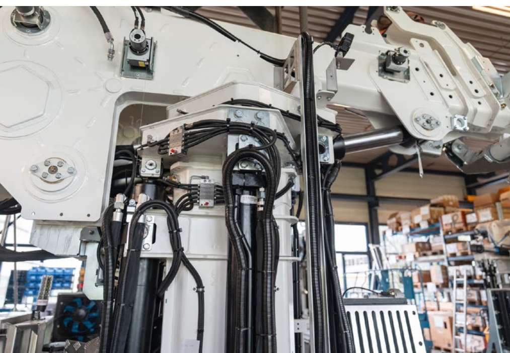
Im Hydraulik-Kran schützen Wellrohre die verbauten Kabel und Leitungen.
